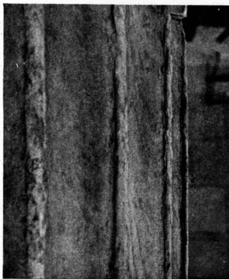
Ф и г. 4. Выветрелая поверхность барабана 15-й колонны после очистки пескоструйным аппаратом.
